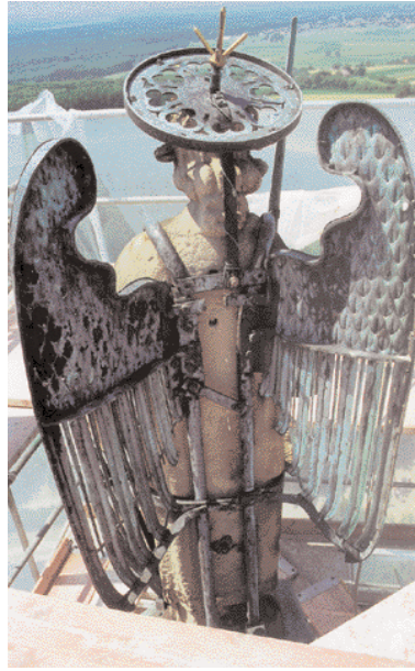
Kreuzenstein, Burg, Kapellenturm, hl. Michael vor Restaurierung, Rückseite
