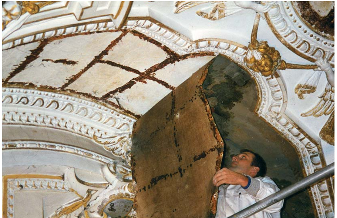
Dürnkrut, Schlosskapelle, Stuckdecke von 1633 mit Marouflagebildern zeigt während der Abnahme von der Decke 1996 streifenförmige Originalklebung.
