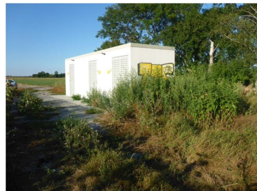
Bild 4: Schaltstation, Ansicht von W
