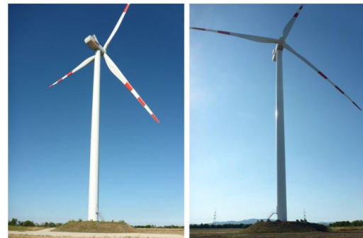
Bild 16: Turm und Rotorblätter WKA TM 8 (links - Blickrichtung OSO, rechts Blickrichtung WNW)
